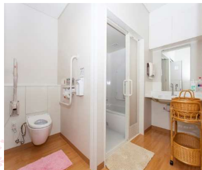
バス・トイレ 快適な設備
