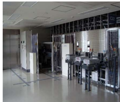
2F 手術器材自動搬送システム
