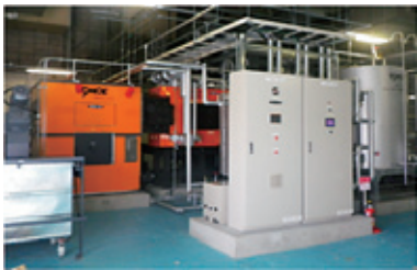
ボイラー全景
