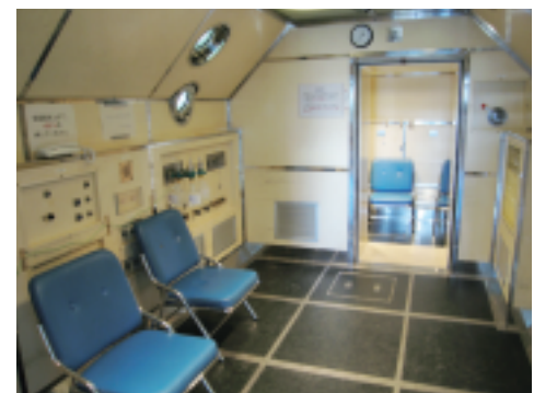
高気圧酸素治療室の内部
