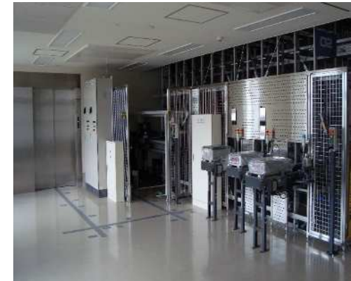
2F 手術器材自動搬送システム
